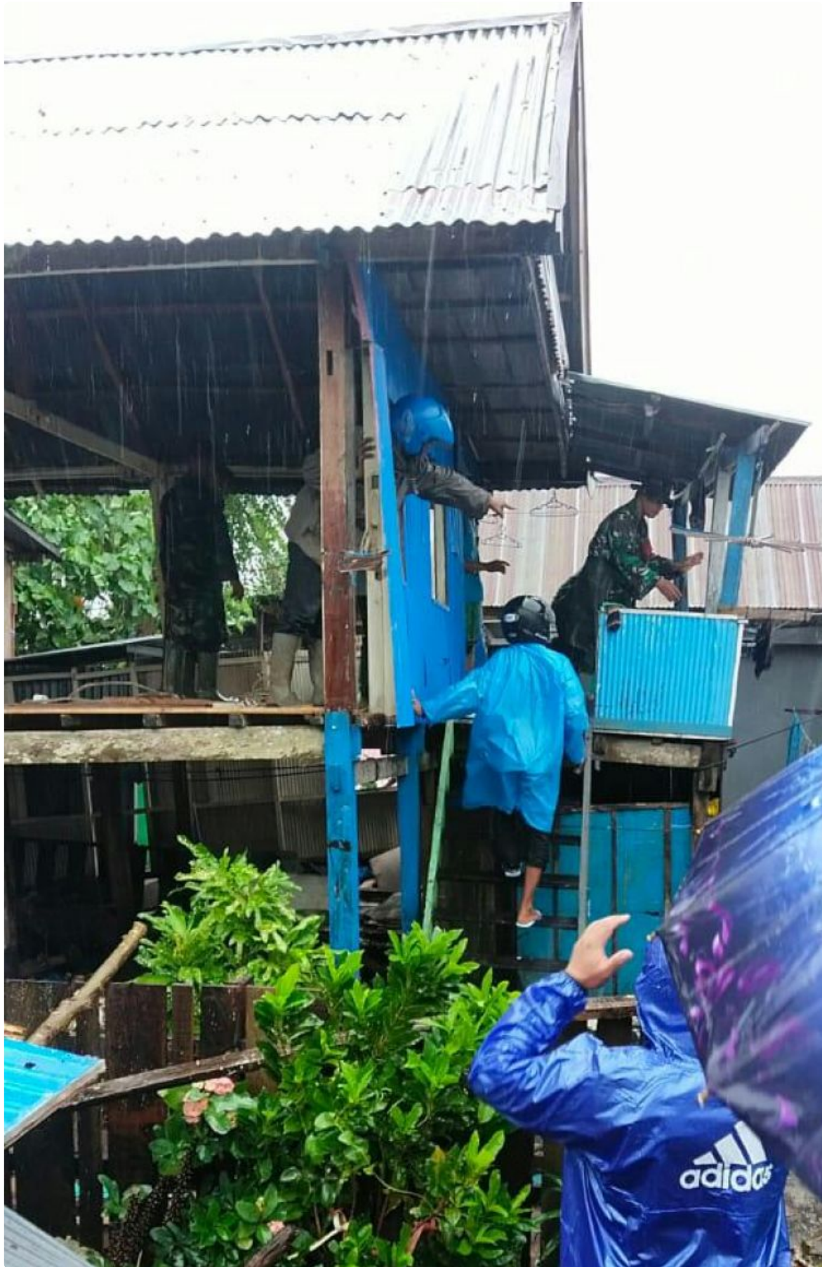
"Tim Sapu Jagat Siaga Bencana Tanete Rilau melakukan kegiatan pembongkaran rumah. Kegiatan ini sebagai bentuk penanganan untuk mengantisipasi hanyutnya beberapa rumah yang ada di pesisir pantai akibat
